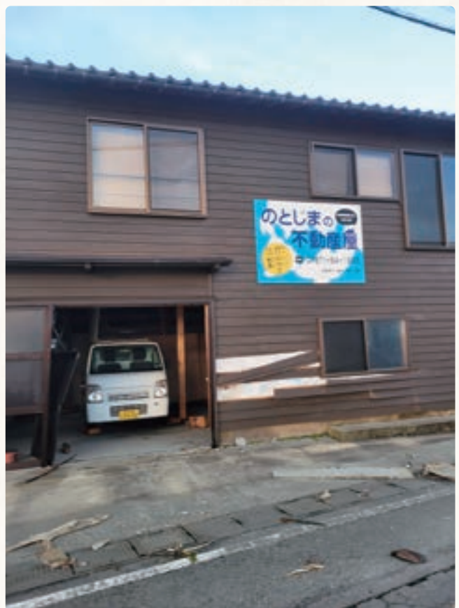
のとじまの不動産屋事務所も津波の被害を受けた
