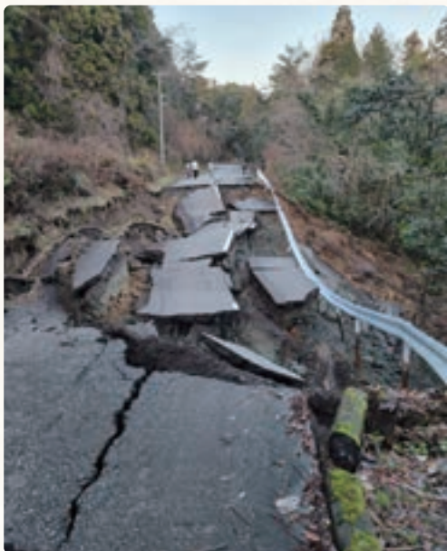
能登島島民の主要道路25年4月現在通行止め
