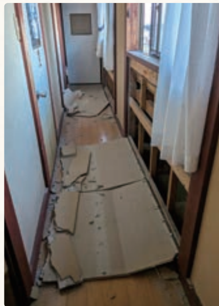
自宅の2階廊下壁が外れて落ちている
