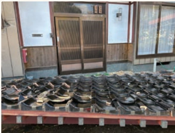
珠洲市にある実家。大学時代を除き、20代半ばまでここで過ごしましたが、地震で屋根が根こそぎとれて下に落ちました。
